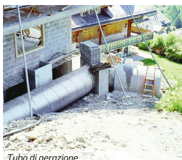
Tubo di aerazione
