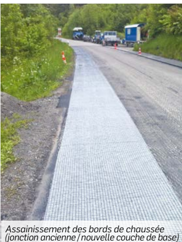
Assainissement autoroute N2 Rivera-Lugano
