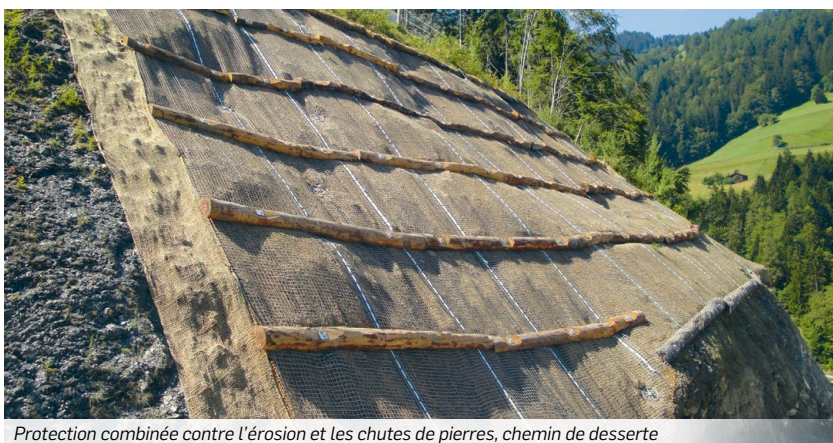
Protection combinée contre l'érosion et les chutes de pierres, chemin de dessert
