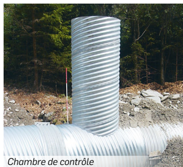
Chambre de contrôle
