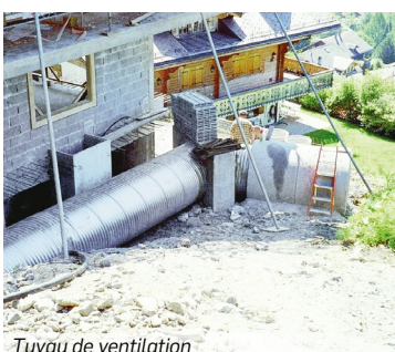
Tuyau de ventilation
